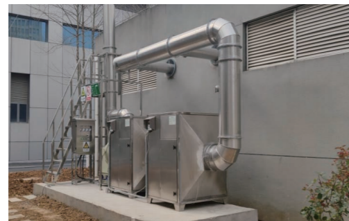
废气排放设备
