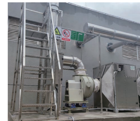
危废暂存间废气处理设施
