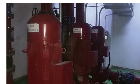
图为冷却水循环水泵,功率为110KW,于2016年进行变频改造后,节省电量30%以上,年节省用电可达50~60万度
