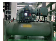
清洗后的制冷机组
